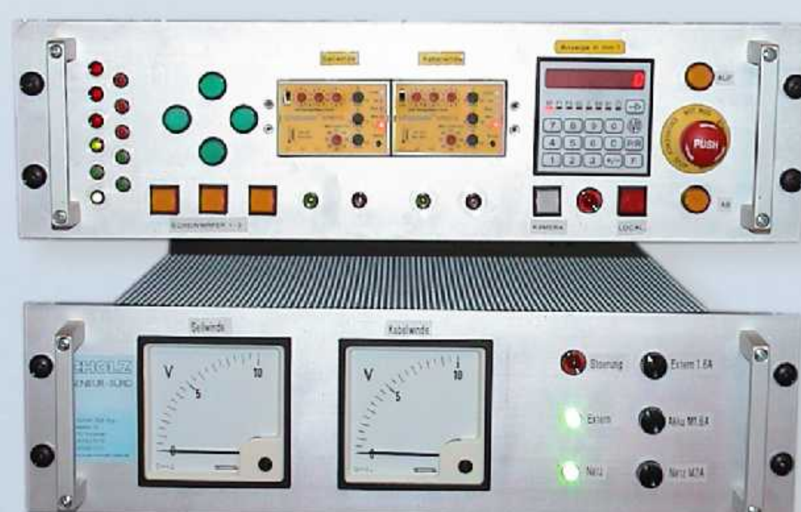
Steuereinheit im PC-Rack
