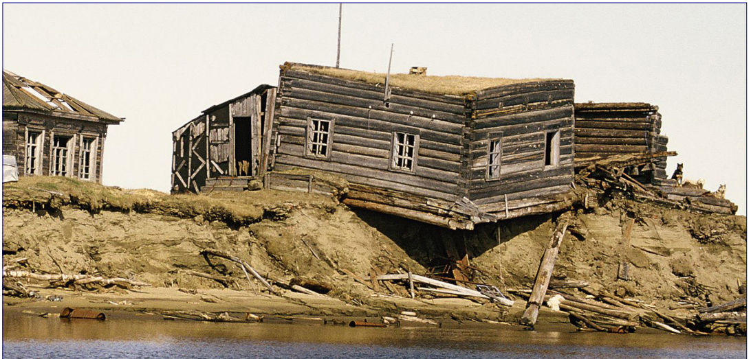
Abb. 3.5-9: Gebäudezerstörung durch Permafrost in einem früheren sibirischen Dorf. Quelle: Flickr (2015): Remnants of a village and former Stalin camp, Siberia, https://www.flickr.com/photos/gridarendal/31942305172/ . GRID-Arendal http://www.grida.no/resources/3576 . Lizenz: CC BY-NC-SA (siehe auch Tafel 4 im Klappentext und https://www.google.com/search?q=Tscherski&source=lnms&tbm=isch&sa=X&ved=2ahUKEwj255uS6-jzAhXRzIUKHW0pAR4Q_AUo-AoEACAEQBA&biw=1536&bih=850&dpr=1.25#imgcr=IUC73U_2nmVKDM ).
